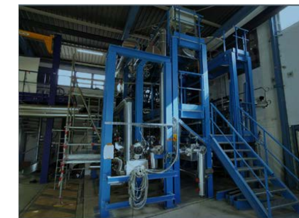
Boucle avec SACO installé
